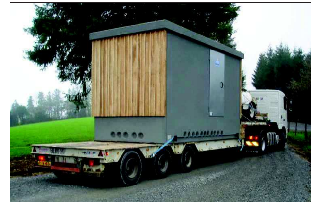
Illustration 5 : Arrivée d'un poste de livraison sur un site éolien (Source : VALECO)
