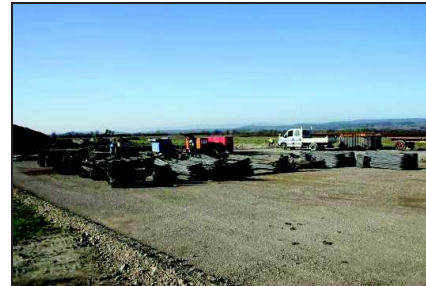
Photo 11 : Stockage des ferrailles
